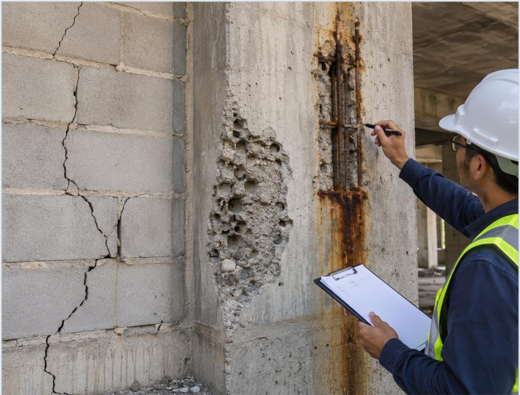
Inspeksi cacat beton dan retak dinding
